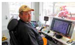
Komradio, dataövervakning och tålamod. Hemdragningen av det 600 meter långa röret tog 17 timmar. Här Fredric Persson i operatörshytten.
