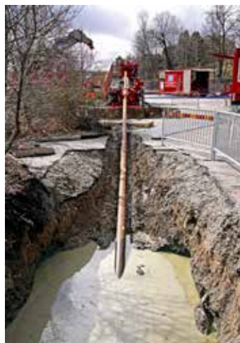
Borrhstängerna försvinner ner i startgropen för att ta en bana på cirka sju meters djup fram mot slutmålet.
